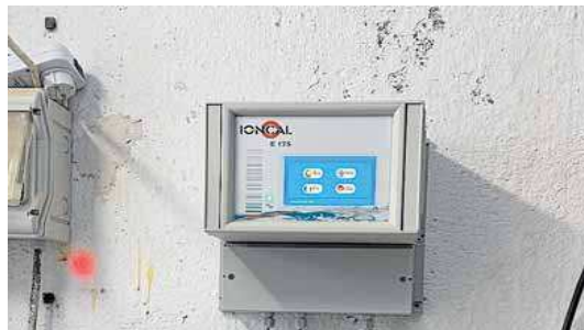
Detalle de uno de los descalcificadores instalados. SUR
