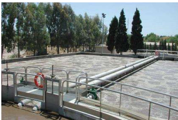
La depuradora de Inca | Foto: R.D.
